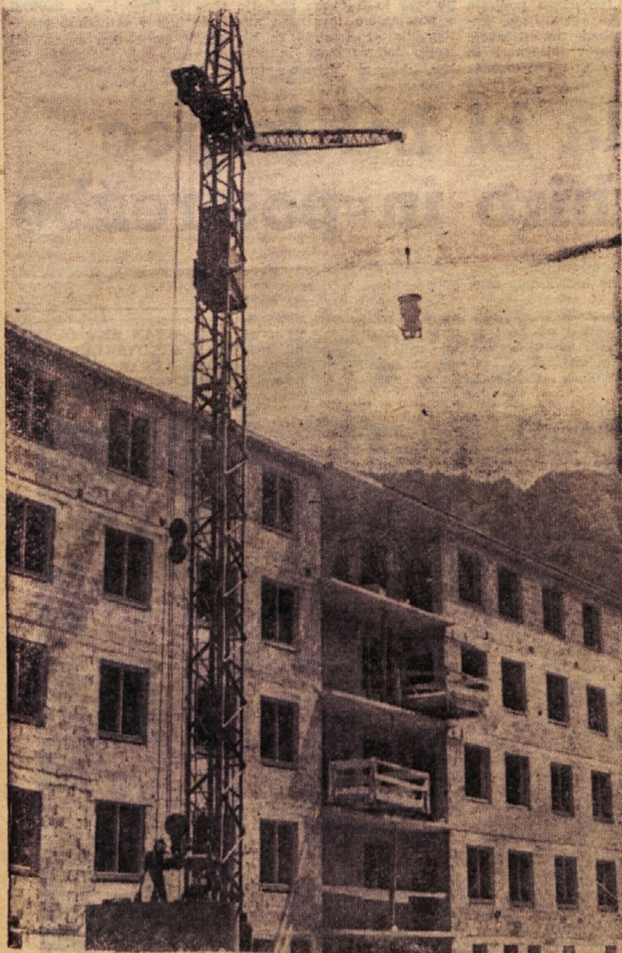
Zagorsko Gradbeno podjetje ima kar precej mehanizacije. Na sliki vidimo žerjav »Pohorec«, ki prav dobro pomaga pri gradnji novega stanovanjskega bloka ob Cesti zmage za Zavod za stanovanjsko izgradnjo
