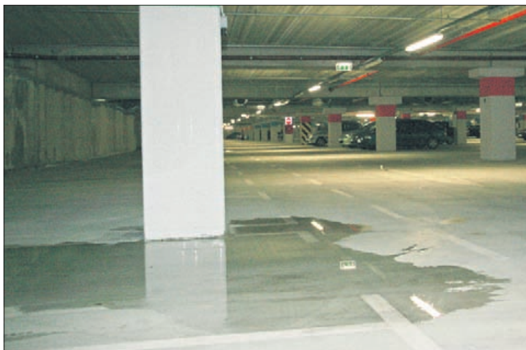
Tudi po sanaciji ni dosti bolje. Voda je še vedno na parkirnih mestih.
