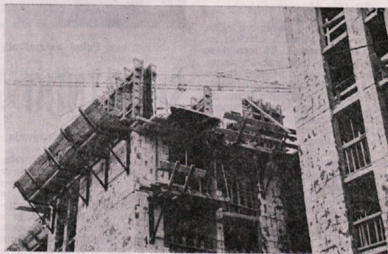
Slika kaže tipičen primer nezadostne tehnične zaščite na objektu
