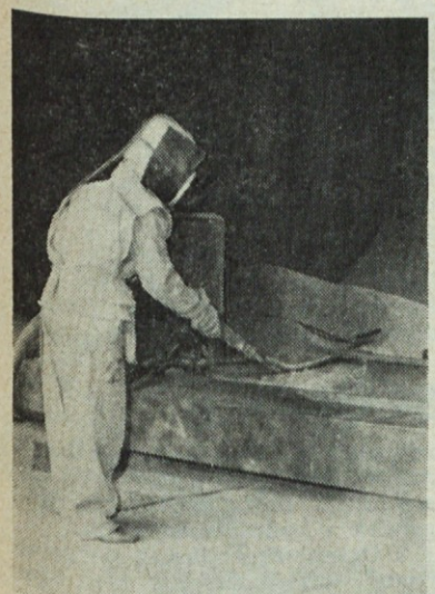
Površinska zaščita, kremenčev prah, ki nastaja pri peskanju, ogroža tudi sosednje objekte in seveda tudi vse, ki so tu zaposleni
