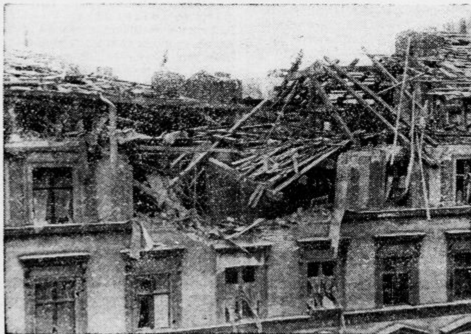
Učinek angleške bombe na neki berlinski zgradbi
