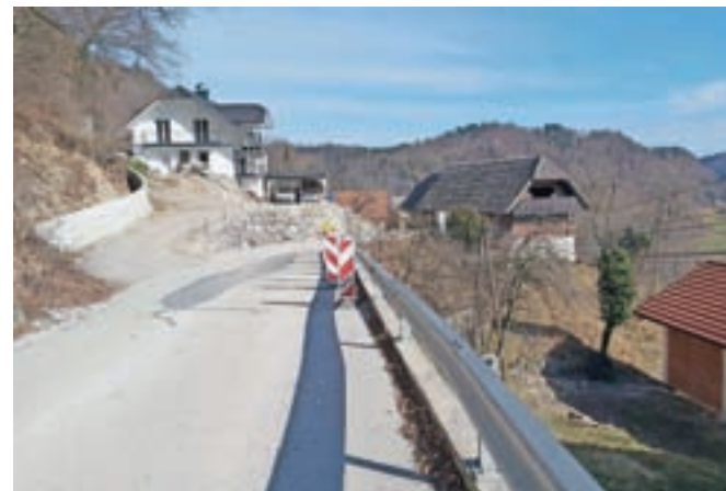
»Sporen« zemeljski plaz, ki ogroža občinsko cesto Kamnik–Vranja Peč, bo saniran v letošnjem letu. / FOTO: JASNA PALADIN
