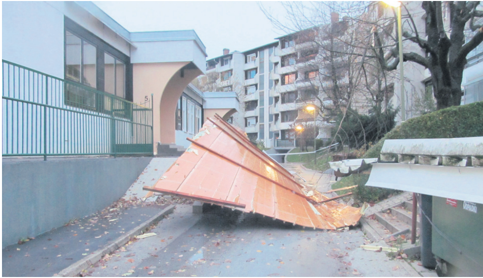
Močan veter je v Velenju največ škode naredil na Gorici, kjer je odkrilo kar nekaj streh. Pločevinasti deli streh so ležali na tleh, drevesih, celo na strehi vrtca.
