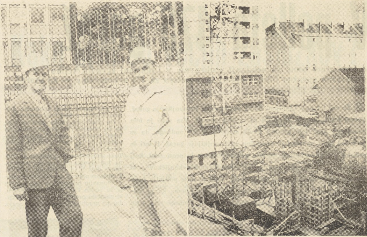
LEVO: Sektorski vodja inž. Vili Stukelj in delovodja Leopold Pepelnjak sta prepričana, da bo stolpnica gotova v aprilu 1970. Prepričani smo, da bosta besedo držala. DESNO: Ob začetku del pri gradnji 17-etažne stolpnice med Titovo cesto in Kersnikovo ulico v Ljubljani
