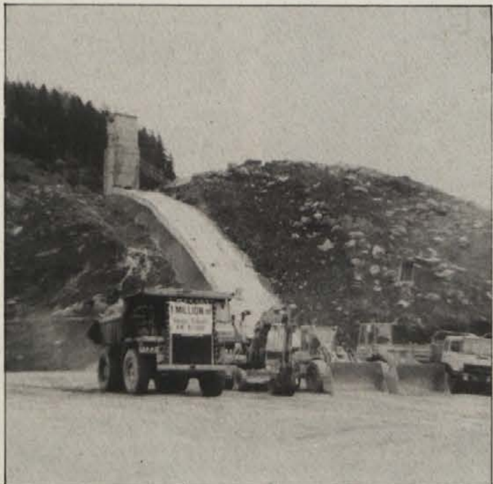
Težki stroji so v nekaj več kot enem letu vgradili milijon kubičnih metrov nasipnega materiala za novo elektrarno.
