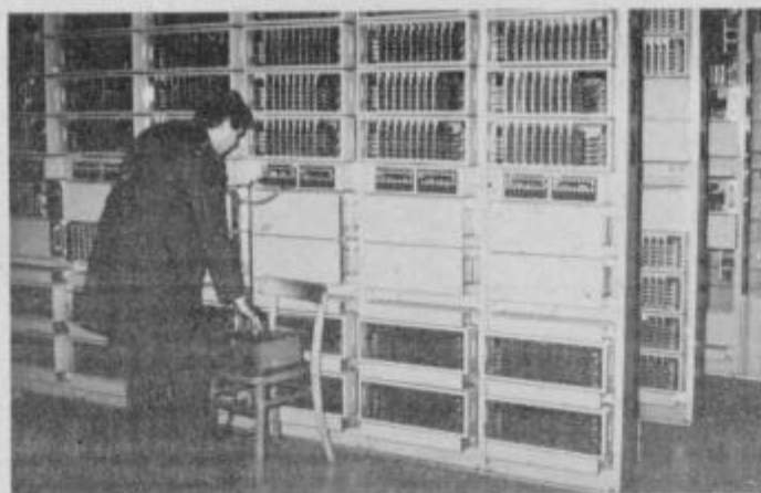
Del avtomatske telefonske centrale v PTT Ptuj.
