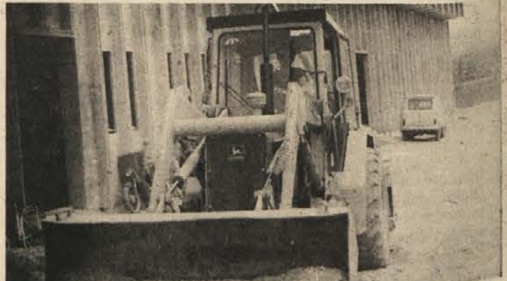
ŠE LEPŠA „OBLEKA“ – Delavci Pionirja hitijo z zemeljskimi deli okoli nove tovarne Iskre v Kostanjevici, da bi do petka asfaltna preproga ozaljšala 2150 m 2 parkirnih prostorov. Do svečanega dogodka bo tako vse nared. (Foto: P.P.)
