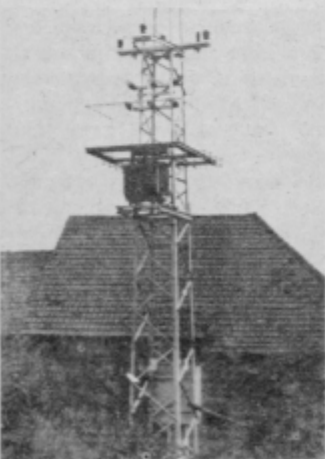
Jamborski transformator — foto zk
