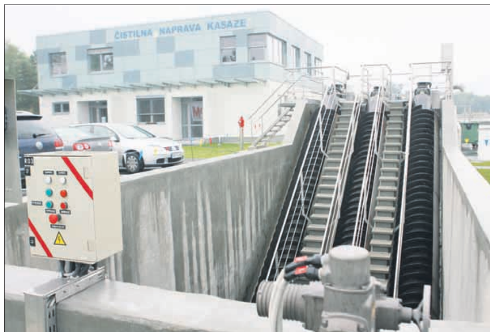
Čistilna naprava v Kasazah je sestavljena iz treh sklopov: linije vode, blata in plina. Poskusno bo obratovala predvidoma do maja prihodnjega leta. Plin, ki nastane pri procesu čiščenja, uporabljajo za ogrevanje in proizvodnjo električne energije.
