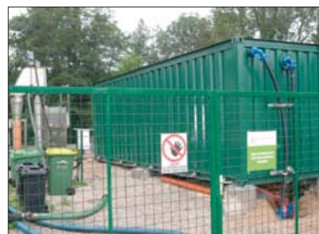
Slika 4: Nova mobilna čistilna naprava v Ponikvah
