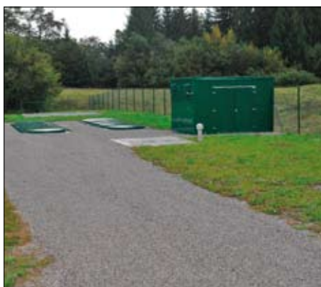
Slika 3: Pogled na vgrajeno čistilno napravo, kjer so vidni le pokrovi ČN.
