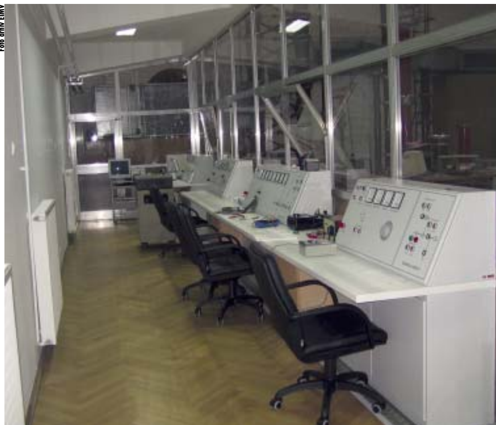
Nova komandna kabina visokonapetostnega laboratorija.
