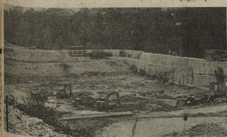
V sedanji fazi gradnje HE Mavčiče potekajo dela v gradbeni jami, iz katere je že izkopano 60.000 kubikov materiala
