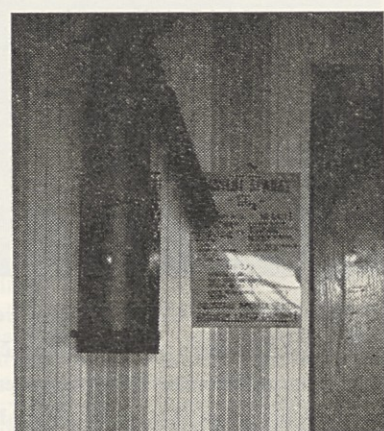
Gasilni aparati opremljeni z navodilom za ravnanje
