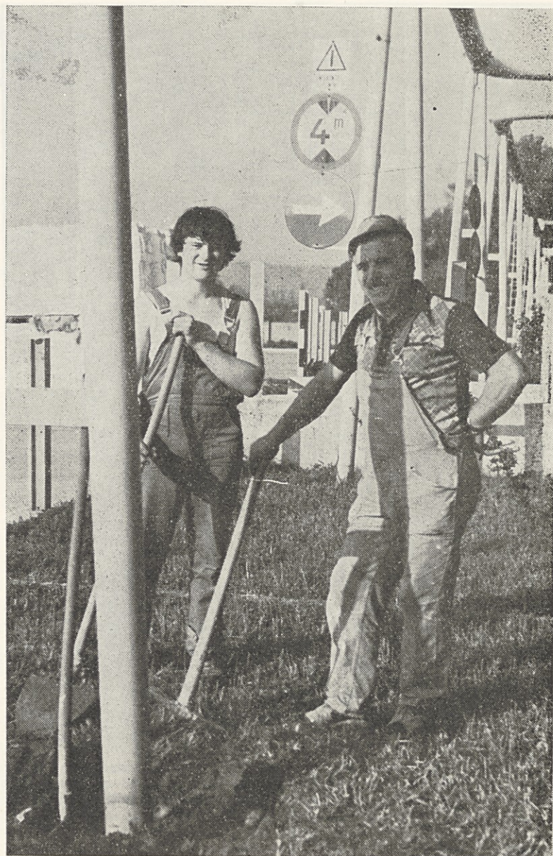
Mojster Marcel Rossi in njegov pomočnik pridno odkopavata zemljo okoli stebrov plinovoda, ker je treba stebre antikorozivno zaščititi
