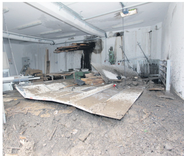
Razdejana mizarska delavnica, ki jo je obnovil Matjaž Melanšek in jo dodatno gradbeno zaščitil pred dvema letoma.
