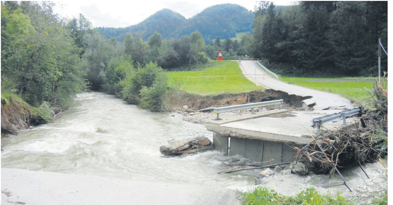
Za smrt mladih Spodnjesavinčanov je najverjetneje kriva neprimerna infrastruktura. Tok Bolske je na območju mostu oviralo naplavljenovojevje. Njenega pritiska niso zdržali most in bregovi v bližini centra varne vožnje. Odtrgali so se in zgrmeli v strugo.
