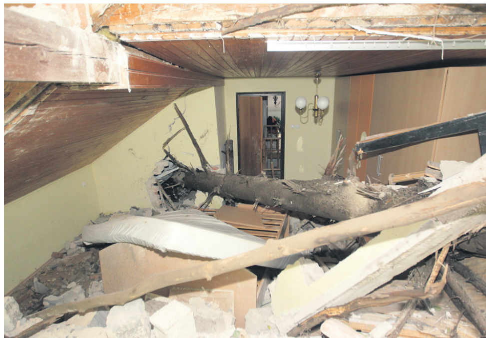
Takole je drevo prebilo steno hiše Zaleznikovih in poškodovalo eno od sob, v kateri je bila takrat snaha Franca Zaleznika.
