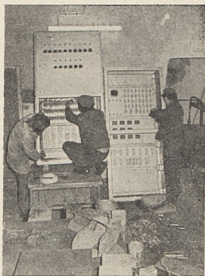
TOZD RŠC je v svoji vajeniški delavnici na Gvidi v Trbovljah, izdelal razdelilno omaro za žičnico alpskega turističnega centra Bovec-Kanin. Te objekte na Kaninu je zgradilo SGP Hrastnik.
