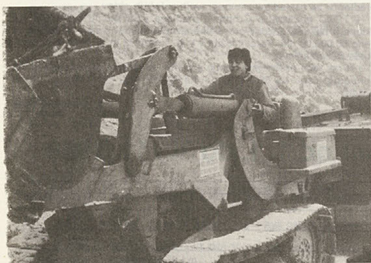
Strojnik Martin Robida premika vrtalno kompozicijo z manjšim nakladačem (Cesta Škofova košenica — Pendirjevka, nov. 83). (Foto J. P.)
