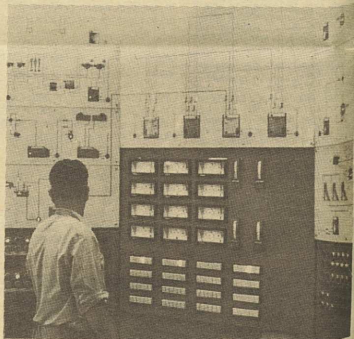
V komandni sobi z nešteti instrumenti je nazorno prikazan potek celotne proizvodnje. Vsak zastoj na kateremkoli stroju se glavnemu kontrolorju pokaže na diagramu. Na ta način lahko kontrolira in sinhronizira celotno proizvodnjo.
