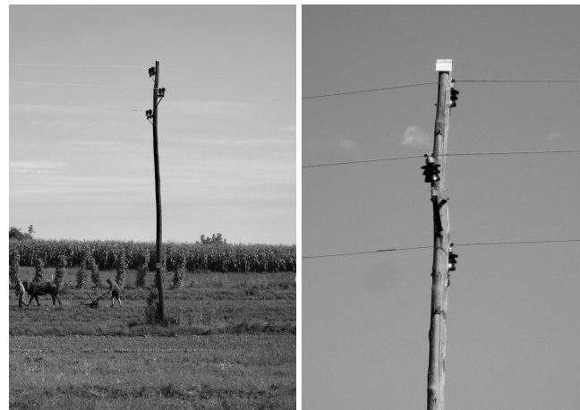
S pločevinasto strešico zaščitena električna drogova sredi polja pod vasjo Orehovec (levo) in na travniku pod vasjo Grič. Foto: Vito Hazler, 18. 8. 2010
