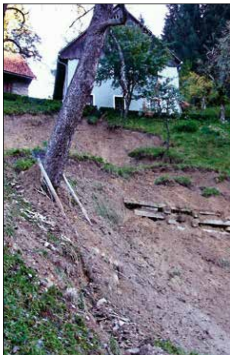
Zemeljski plaz pod hišo v Heblarjih.
