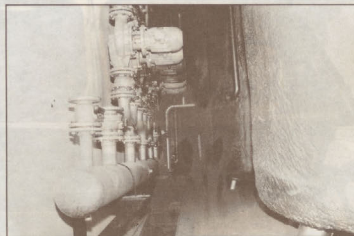
Akumulacija z novim razvodom tople in vroče vode
