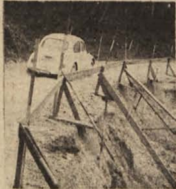
BO NARAVA DOBRODUŠNA? - Najkrajšo zvezo Sevnice z Ljubljano po Mirenski dolini ogroža že lep čas posedanje ob robu ceste nad kmetijo Flajsovih v Sp. Vodalah. Posedla se je prvotna ograja, slika pa kaže, da se je cestišče podsolu v glavnem že tudi pod na novo postavljeno zasilno ograjo. Očitno bodo cestarji korenitejšje ukrepali, ko se jim bo podsol dobršen del ceste!
