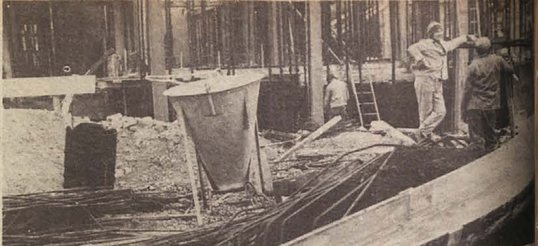
ZELEZO IN BETON. To je podoba z gradbišča za novi delavski dom in hotel na levem savskem bregu v Krškem. Oba objekta gradi SGP Pionir, ki zagotavlja, da bosta dokončana do roka. Potemtakem govorice o preložitvi proslave petstoletnice Krškega niso utemeljene. (Foto: Jožica Teppey)
