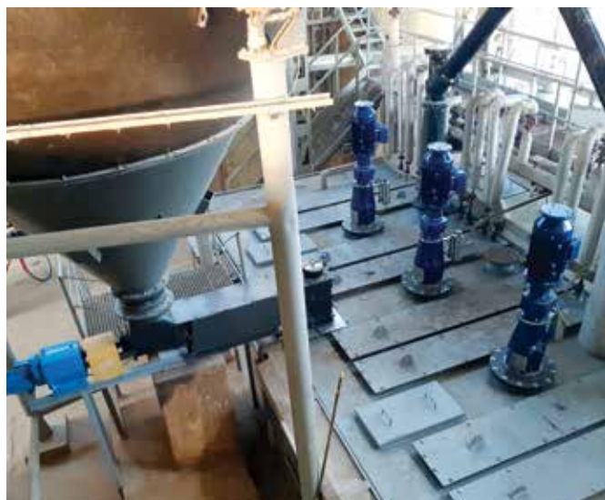
Zalogovnik za žveplo s polžem in obnovljen talilni bazen z novimi mešali.
