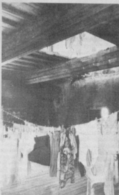
Takšen je zdaj pogled na nekdanjo imenitno sodno dvorano s prelepo rezljanim lesenim stropom na gradu Lemberg. Le nekaj tramov je še ostalo, vse skupaj pa prekriva goba in vlaga. Še perilo spodaj, v nekdanji najbolj imenitni sobi, se nerado suši.
