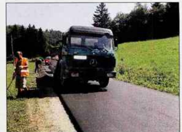
Osemsto metrov ceste od Šenturške Gore proti Sidražu je že v novi asfaltni prevleki, sedaj posipajo bankine.
