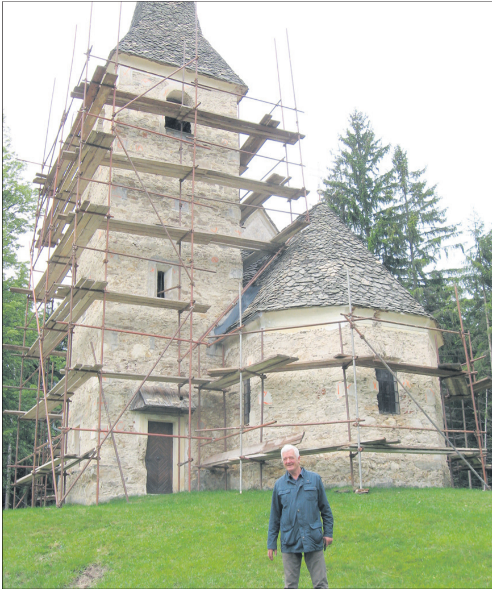
Na Hudinji obnavljajo podružnično cerkev sv. Vida, kjer so pred nekaj dnevi odkrili fresko sv. Krištofa. Pred cerkvijo predsednik gradbenega odbora Viktor Kotnik.
