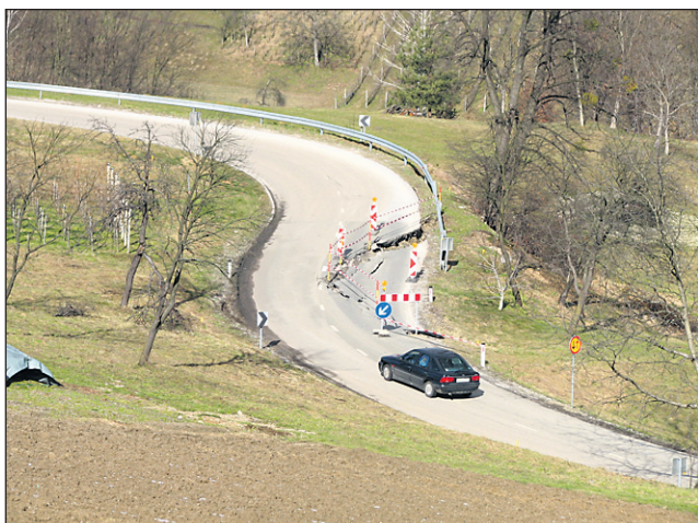
Velik udor je tudi na delu regionalne ceste Polenšak-Savci. Foto: SM
