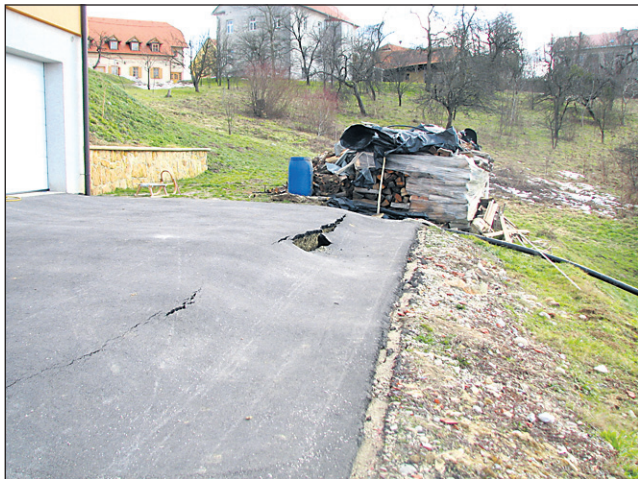
Na asfaltiranem spodnjem delu dvorišča je polzeča zemlja že potegnila s seboj del asfaltne prevleke, zazevala je velika razpoka. Foto: SM
