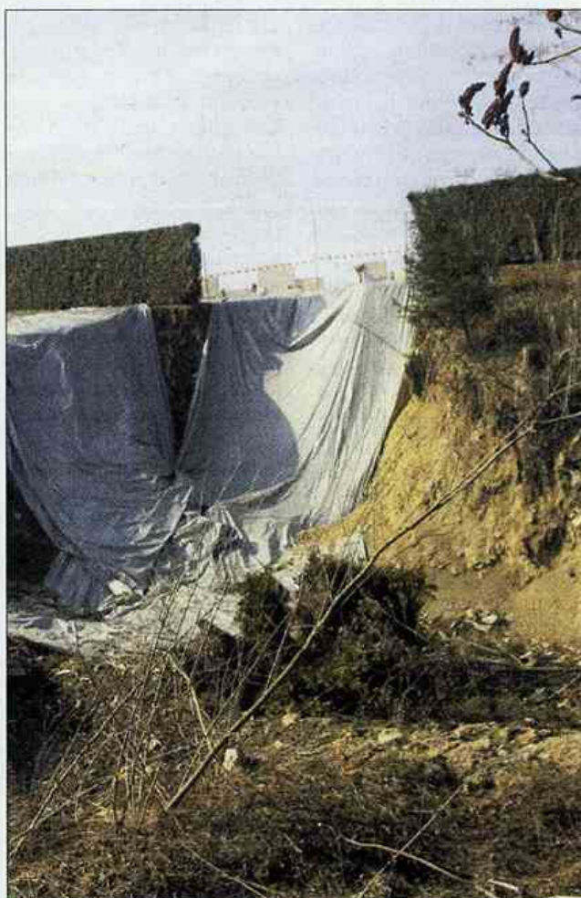
V lanski povodnji sprožen plaz na griškem pokopališču naj bi sanirali prihodnji mesec.
