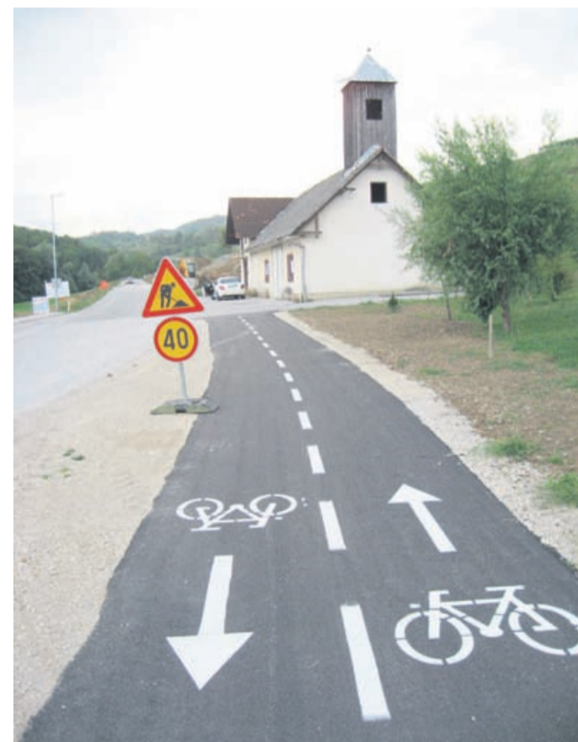
Letos gradijo kolesarsko stezo Sela-Virštanj, ob kateri v teh dneh sanirajo plaz. Plaz je med drugim ogrožal star gasilski dom (na sliki) in sprl gasilce.
