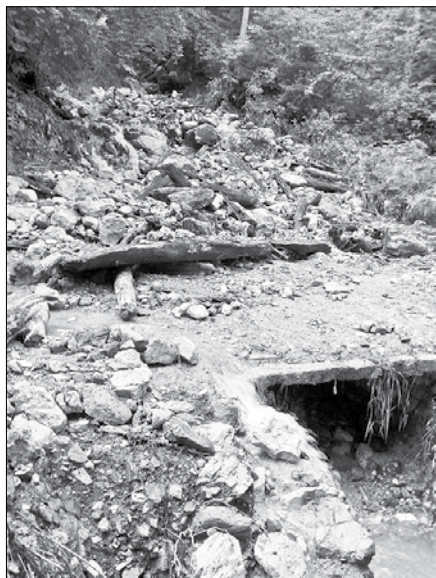
Mostni graben je na nekaterih odsekih močno poškodoval cesto do Krapletove domačije. (Fotodokumentacija Občine Nazarje)
