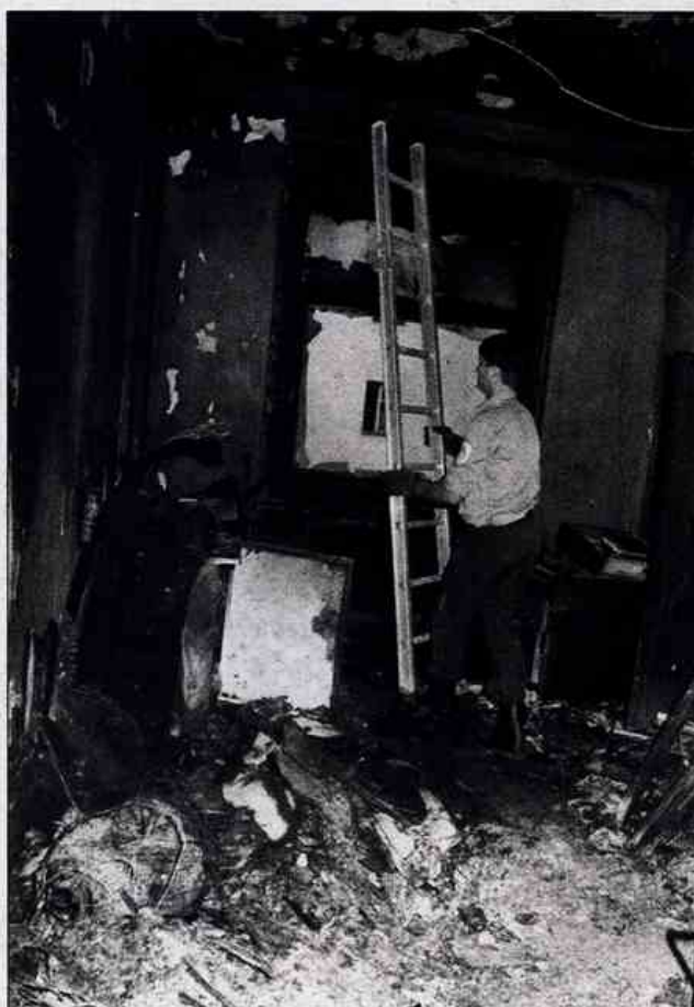
Hud požar je radijske prostore prizadel leta 1990 in potrebno jih je bilo obnoviti v celoti.
