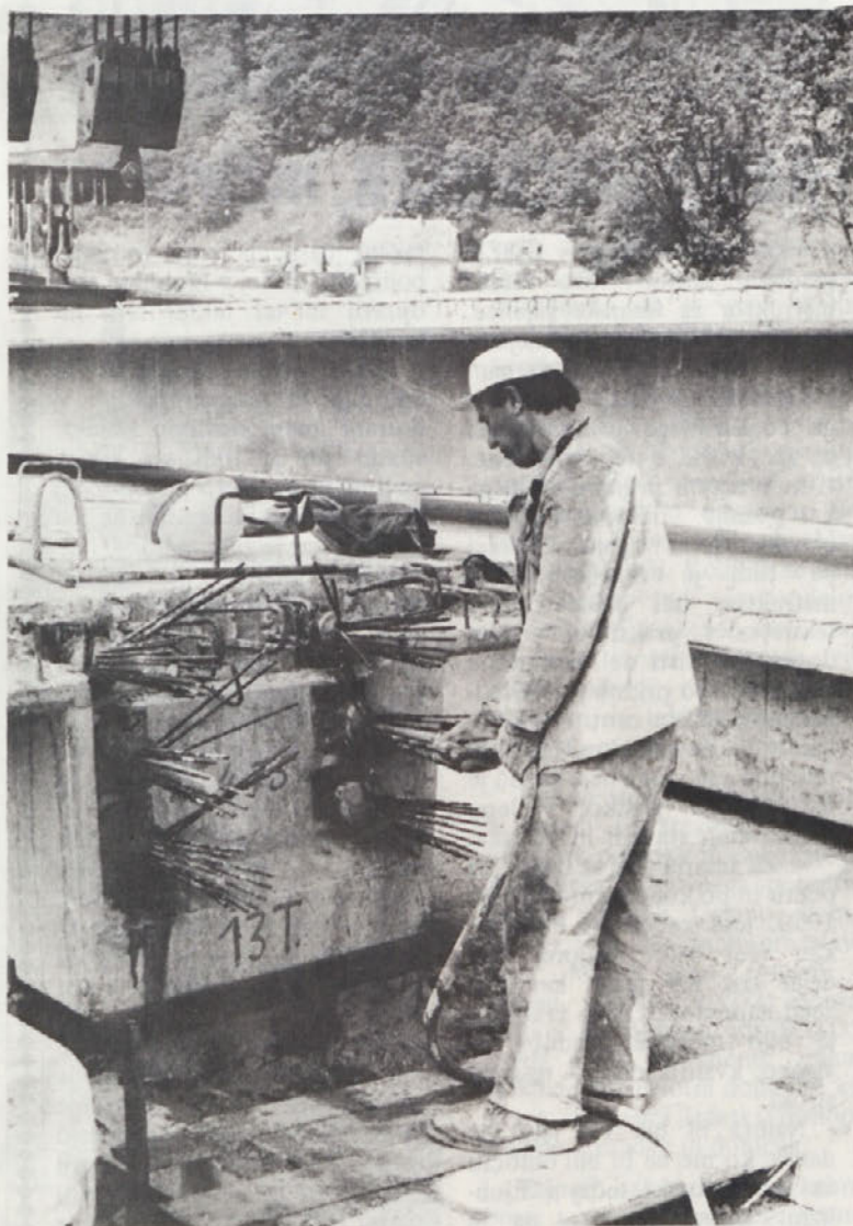
Pri montažni gradnji železniškega nadvoza v Krškem, ki jo opravlja TOZD Gradbeni sektor Krško, zaliva delavec na sliki, stike kablov z betonskim mlekom
