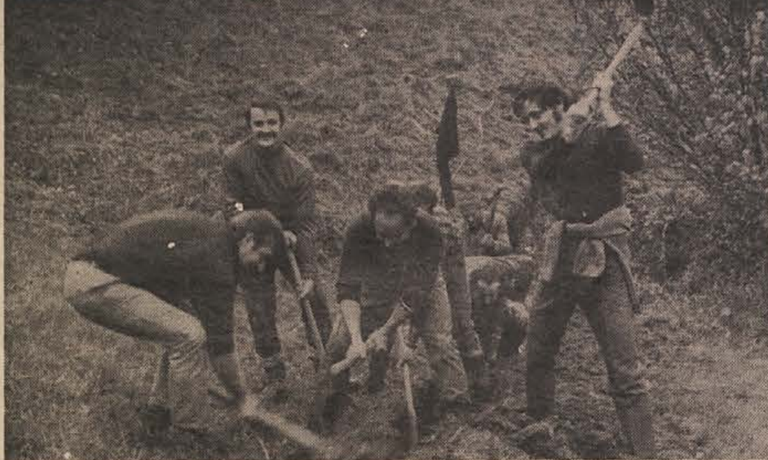
Skupinica navdušenih smučarjev je v nedeljo kopala jarek za električni kabel in ozemljujev; takih prostovoljcev je imel ROG v Črmošnjicah zadnjo nedeljo kar 40 (Foto: T. Gošnik)
