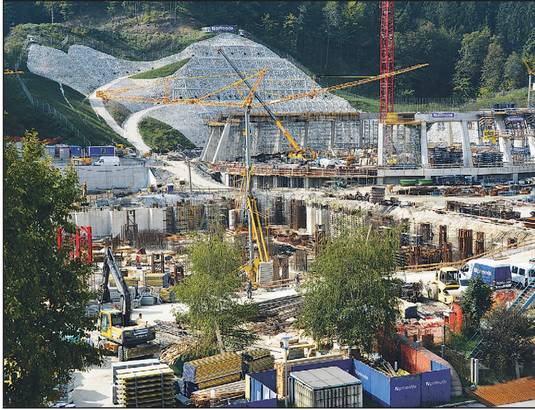
Dela na gradbišču potekajo hitro, saj želijo čim bolj izkoristiti toplo jesensko vreme. Intenzivno pa v Alstomu izdelujejo tudi glavno tehnološko opremo.
