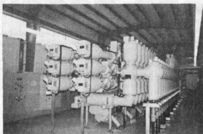
Novo 110 kV stikališče šoštanjske termoelektrarne sodi med najsodobnejša in nanesljivejša v Evropi
