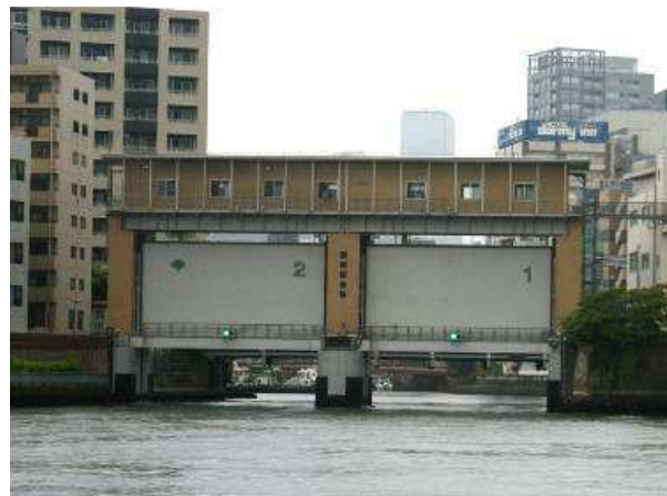
Slika 8: Zapornica na vtoku v rečni kanal
