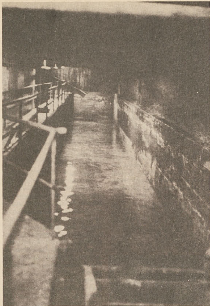
Flotacijski bazen, zbiralnik odpadlega laka. očistimo vsakih šest mesecev. Pogoj za čiščenje le-tega je zaustavitev proizvodnje. Delo je predvsem umazano in naporno. Slika prikazuje že očiščen bazen, ki se ponovno polni z vodo.
