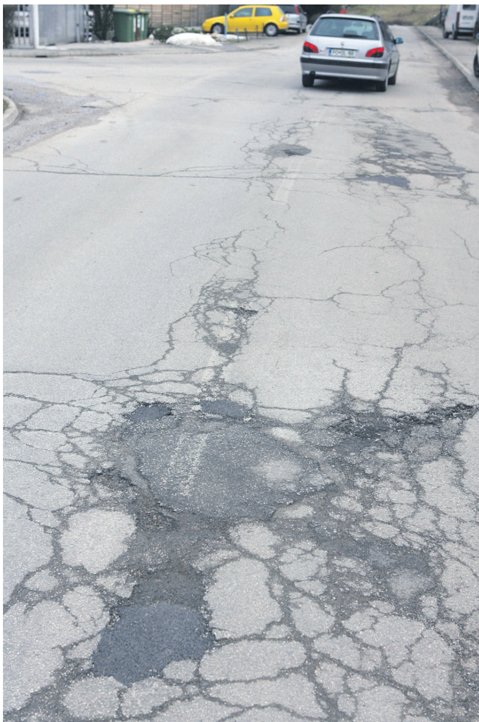
Posledice poškodb na cestišču se na naših vozilih seveda poznajo tudi, če ne pride do prometne nesreče. Najpogostejše so poškodovani pnevmatike, platišča in podvozja, kjer se pojavljajo med drugim poškodbe nihajnih rok, stabilizatorjev in končnikov volanske letve.
