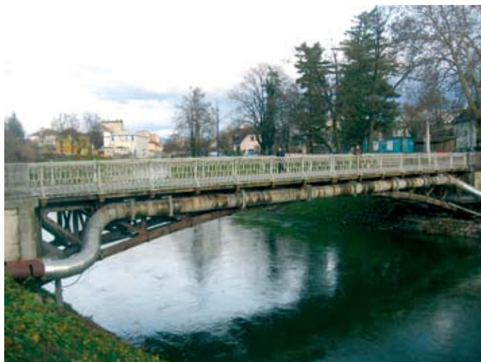
Slika 1: Johann Hermann: trije členkasti loki sestavljajo Hradeckega most (Mrtvaški most) v Ljubljani.
