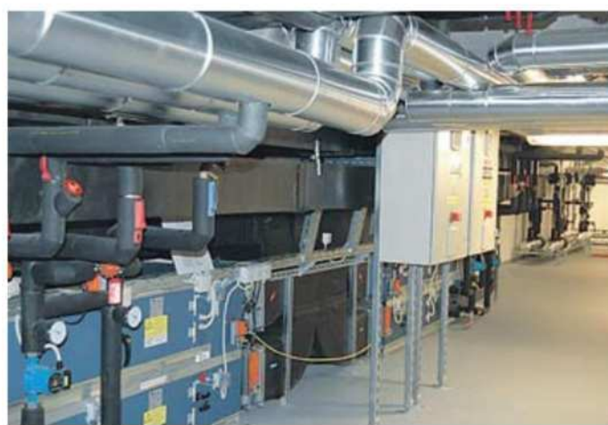
Drobovje razdelilne strojnice v prenovljenem hotelu Izvir
