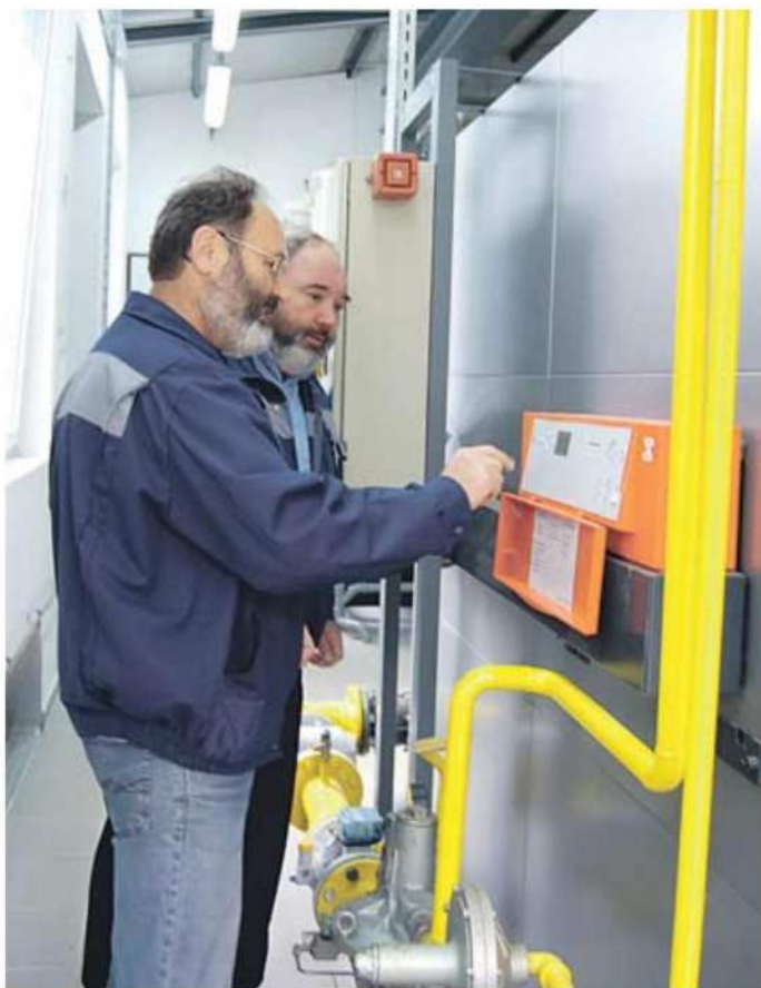
Felix Kovačič in Rafael Jerič pri glavni novi kotlovnici
