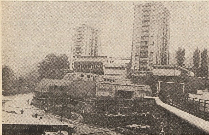
Gradnja drugega dela blagovnice v Hrastniku lepo napreduje. Zadaj stanovanjske stolpnice na Logu. Foto A. Bregant
