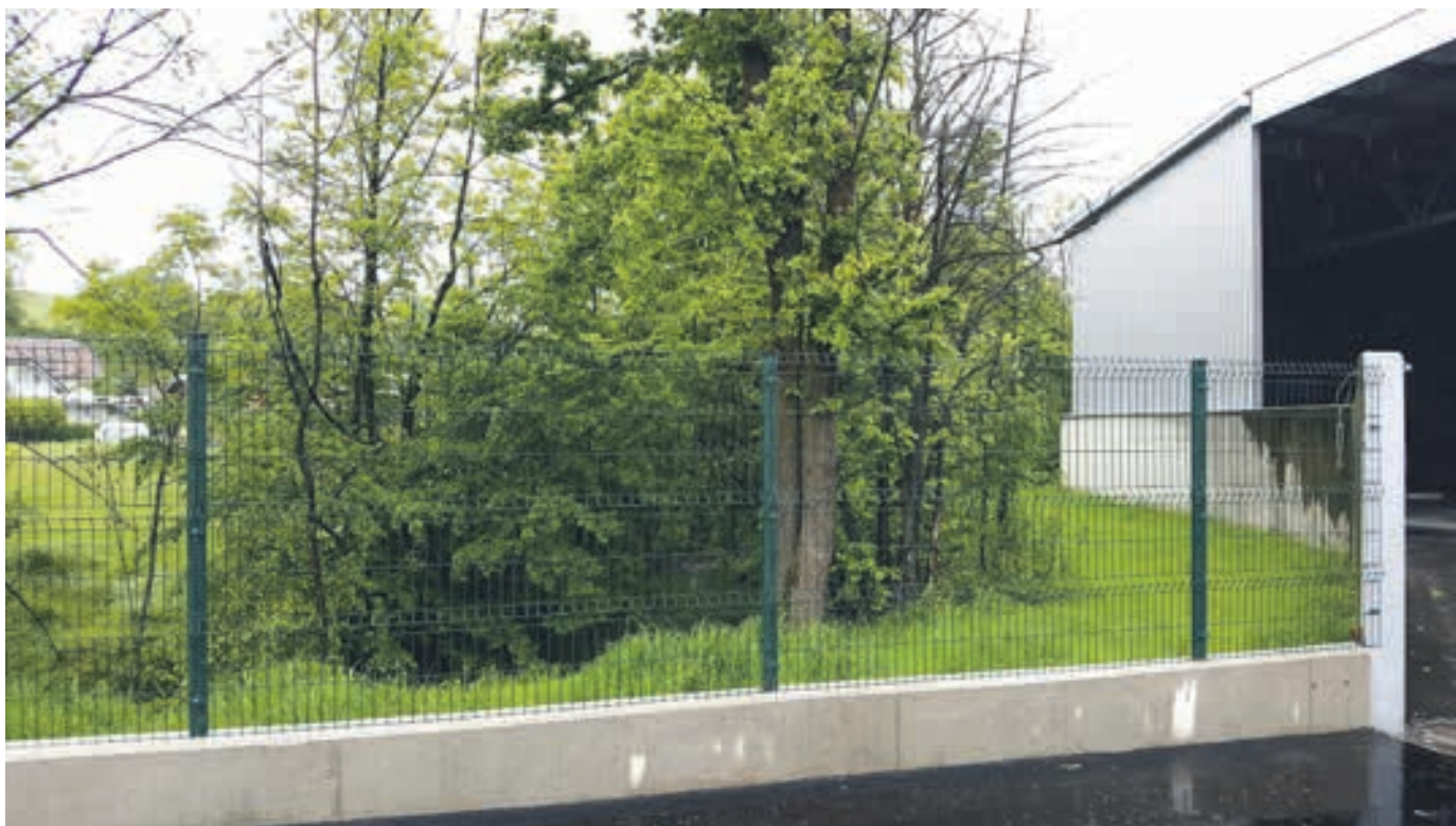
Mesto preliva gasilnih voda po sanaciji
