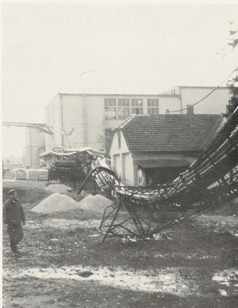
Nosilna konstrukcija se je podrla v veliki dolžini
