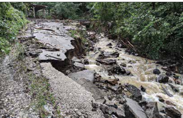
V takšnem stanju je cesta v zaselek Ter.
