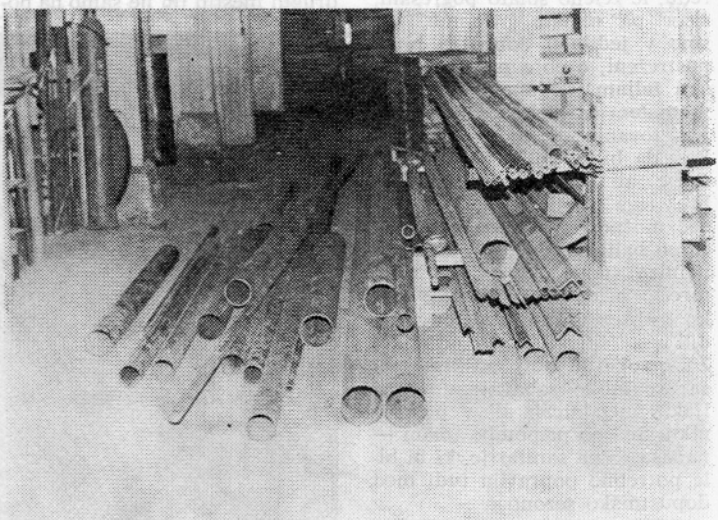
V centralnem skladišču so bile cevi v času montaže razpenjalnega sušilnika kar lepo razmetane
