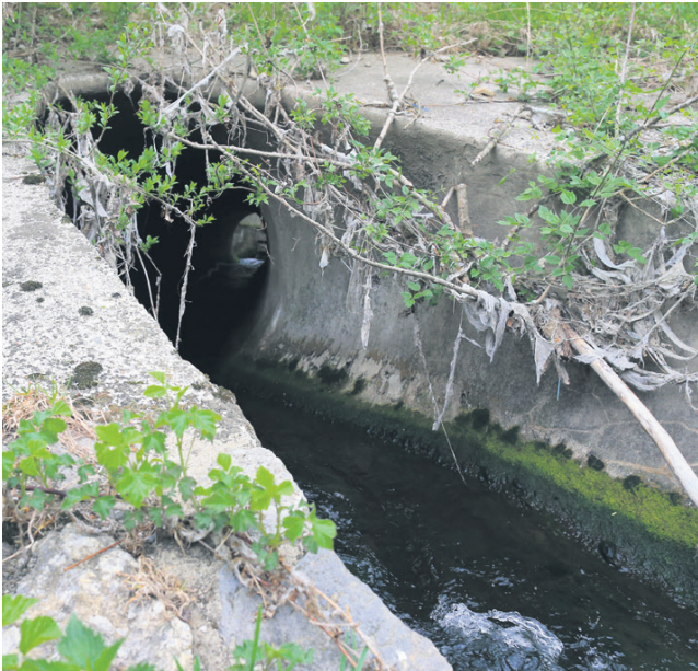
Stroški omrežnine so se od leta 2013 povečevali predvsem zaradi novih sistemov, ki jih je JKP Žalec prevzelo v upravljanje. (Foto: SHERPA)
