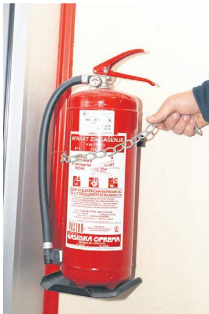
Gasilni aparati morajo biti nameščeni v skupnih prostorih stanovanjskih blokov. Na vsakem gasilniku je na kratko opisan postopek uporabe.
