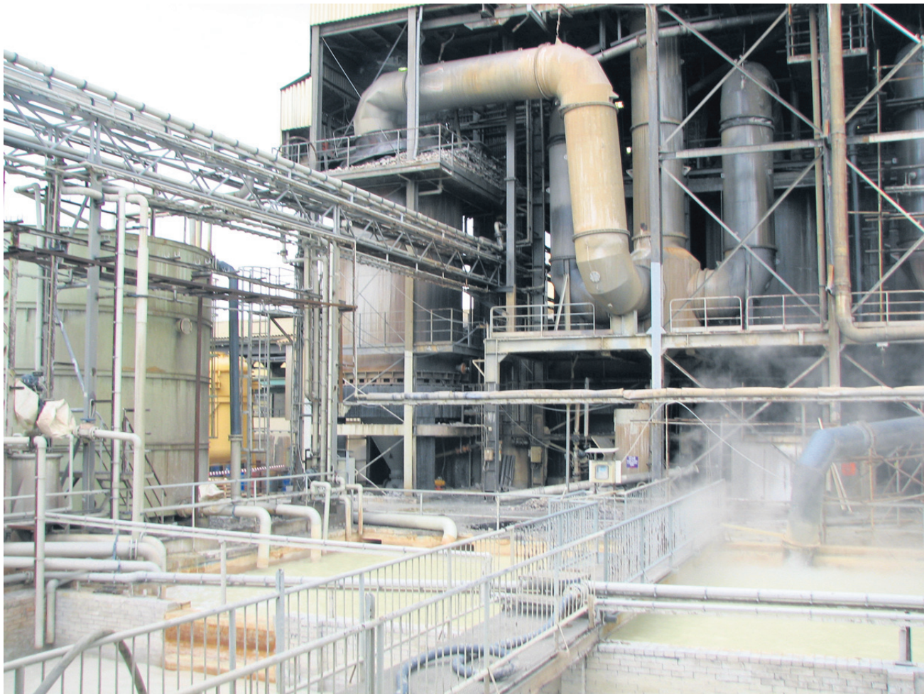
Notranjost stolpa, kjer je prišlo do eksplozije. Na levi strani zgoraj se na cevi vidijo poškodbe, pod njo pa tudi razsuta ruda. (Foto: arhiv CC)
